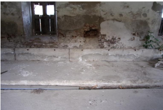
(foto del 13/05/2015 dopo trattamento con Igridry a sx ed acqua distillata a dx)
